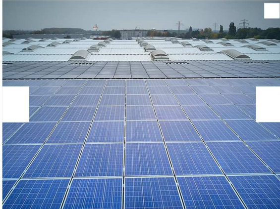
Dachansicht der Second-Life Photovoltaik-Anlage der HME.
