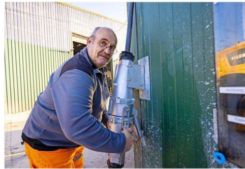
Baggerfahrer Thomas Mislintat kontrolliert die riesige Steckdose, die den Elektrobagger über ein Kabel dauerhaft mit Strom versorgt. Die Firma Damm hat extra für den E-Bagger 300 Meter Erdkabel auf dem Gelände des Recyclinghofes in Grambek verlegt und neue Anschlussdosen wie diese eingerichtet. Quelle: Agentur 54*
